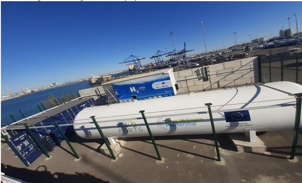
Figura 42 - Hidrogeneradora del proyecto H2Ports ubicada en el Puerto de Valencia.
