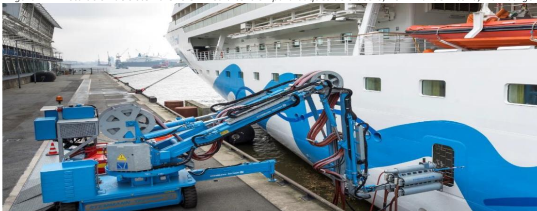
Figura 24 - Instalación de sistema OPS en media tensión para buques de crucero, Terminal de Altona, Hamburgo.
