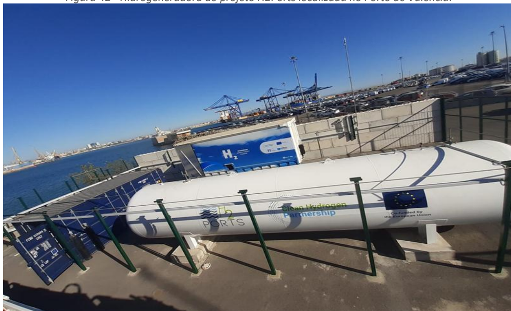
Figura 42 - Hidrogeneradora do projeto H2Ports localizada no Porto de Valência.
