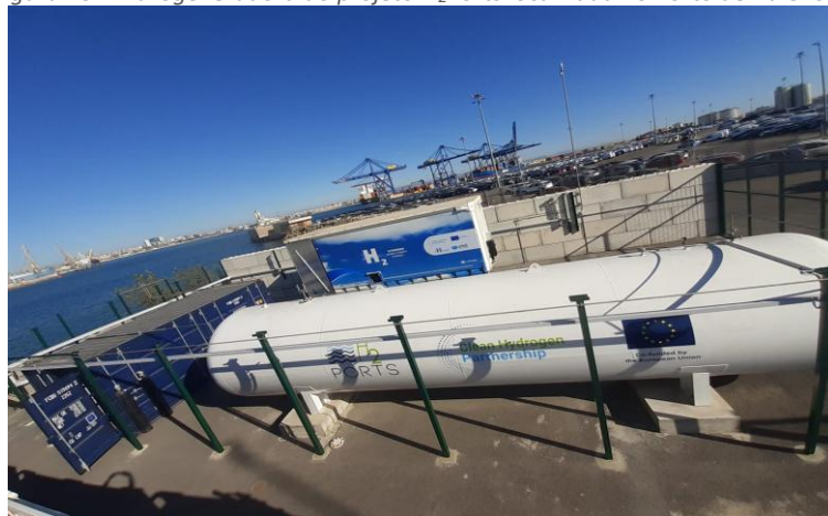
Figura 75 - Hidrogeneradora do projeto H 2 Ports localizada no Porto de Valência.
