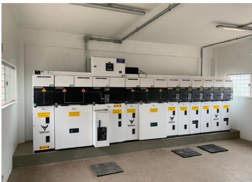
Figura 64 - Painel de média tensão da EMAP [6].
