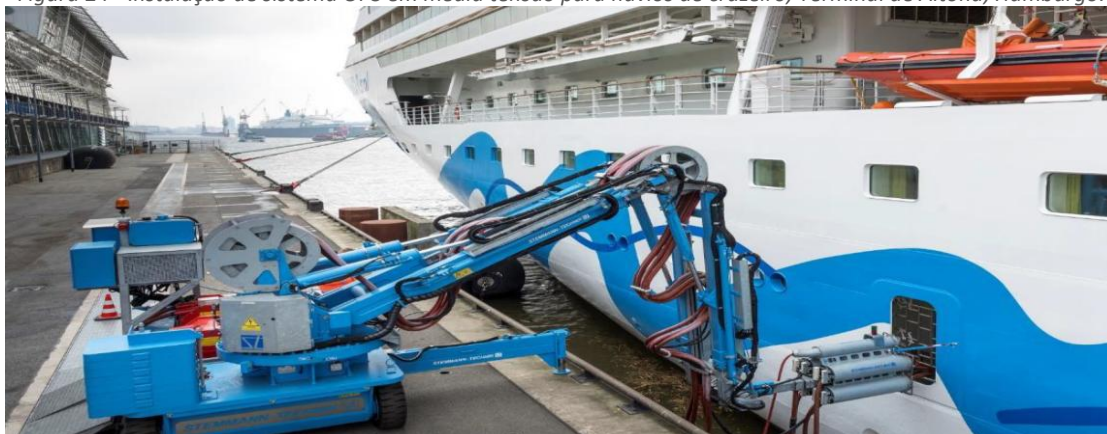
Figura 24 - Instalação de sistema OPS em média tensão para navios de cruzeiro, Terminal de Altona, Hamburgo.
