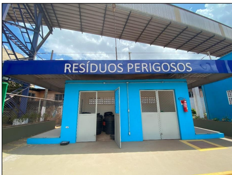
Figura 20: Resíduos perigosos armazenados na central de Resíduos Perigosos existente no Porto Organizado do Itaqui.
