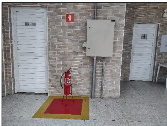
Figura 13: Extintor de incêndio na área dos Berços, no Porto Organizado do Itaqui.
