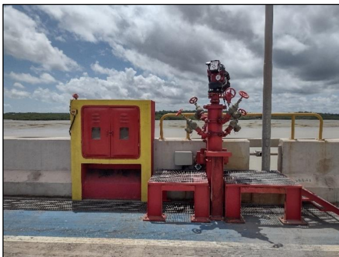
Figura 15: Estrutura de combate a incêndio na área dos Berços, no Porto Organizado do Itaqui. Fonte: Agregar Ambiental, 2022.
