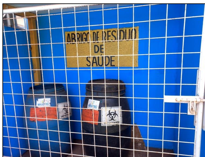
Figura 44: Abrigo de Resíduos de Serviço de Saúde, com recipientes para armazenamento de resíduos infectantes.
