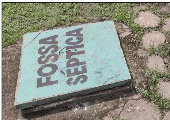
Figura 11: Área de acesso a fossa séptica no Porto Organizado do Itaqui.
