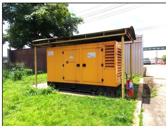
Figura 10: Gerador de energia elétrica existente no empreendimento para uso no caso interrupção do serviço. Fonte: Agregar Ambiental, 2022.
