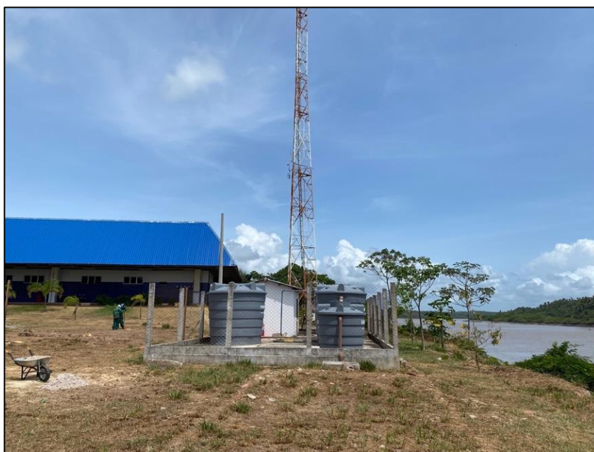
Figura 13: Estação de Tratamento de Efluentes do empreendimento em estudo. Fonte: Agregar Ambiental, 2021.
