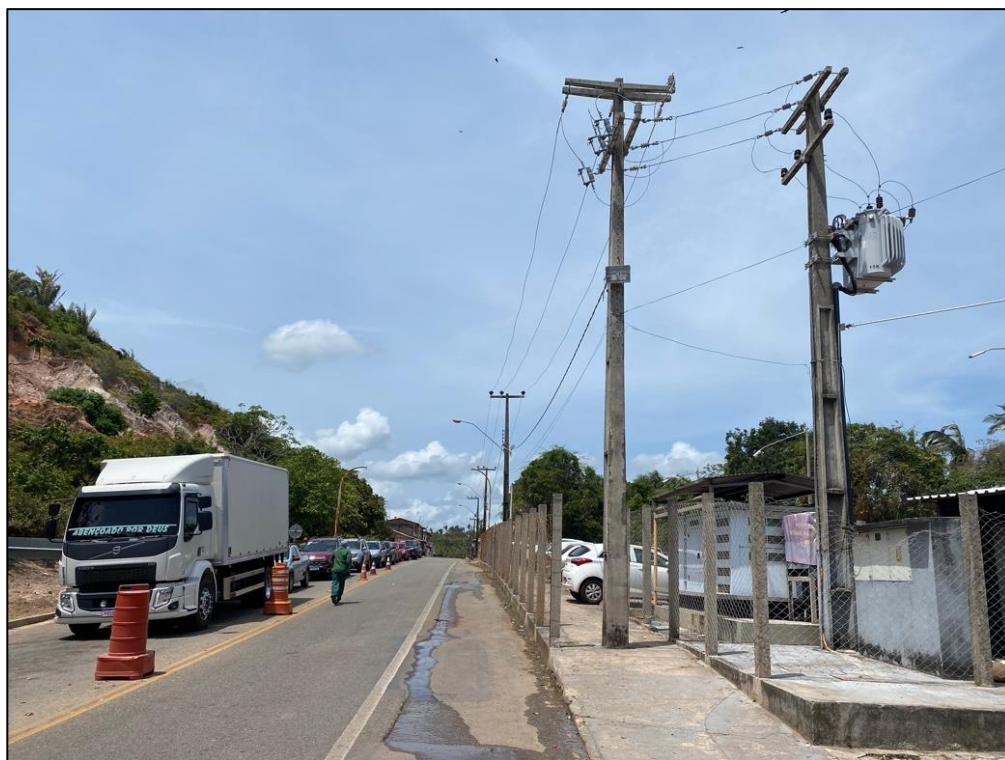
Figura 11: Rede elétrica trifásica que atende o empreendimento em estudo. Fonte: Agregar Ambiental, 2021.
