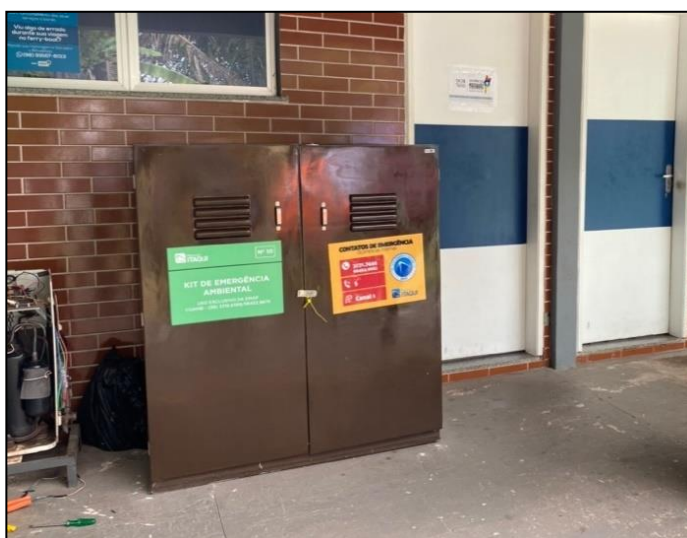
Figura 35: Kit de emergência no Terminal de Passageiros de Ponta da Espera. Fonte: Agregar Ambiental, 2021.
