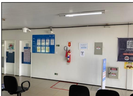
Figura 18: Extintor de incêndio na área do terminal de passageiros.
