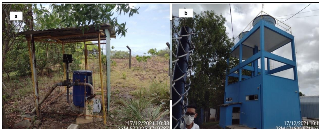
Figura 15: 15a – Poço nas dependências do terminal de passageiros; 15b – Caixas d’água que fornecem abastecimento hídrico ao estabelecimento.
