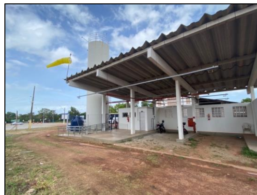
Figura 17: Castelo d’água para abastecimento de caminhão do Bombeiro em caso de necessidade.
